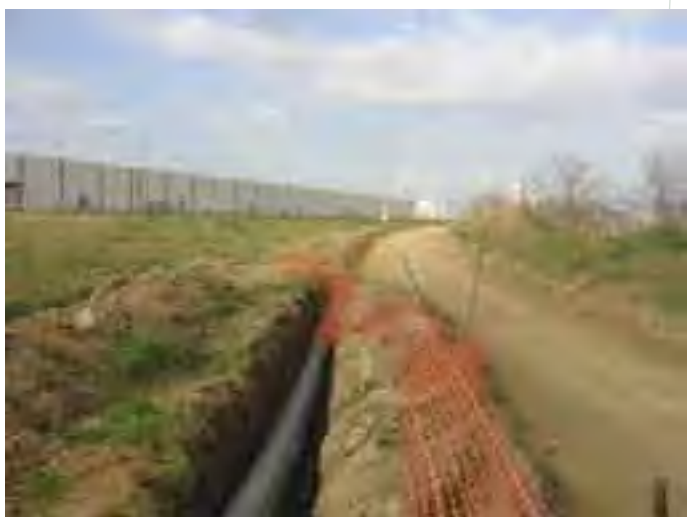
Tuberías para la conducción del agua
